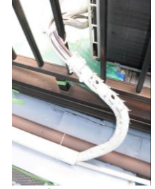
テープが劣化し露出した冷媒管
