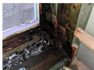
窓台の腐れ (タイルを解体した状態)
